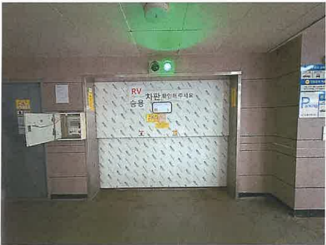
본건 기계식 주차시설
