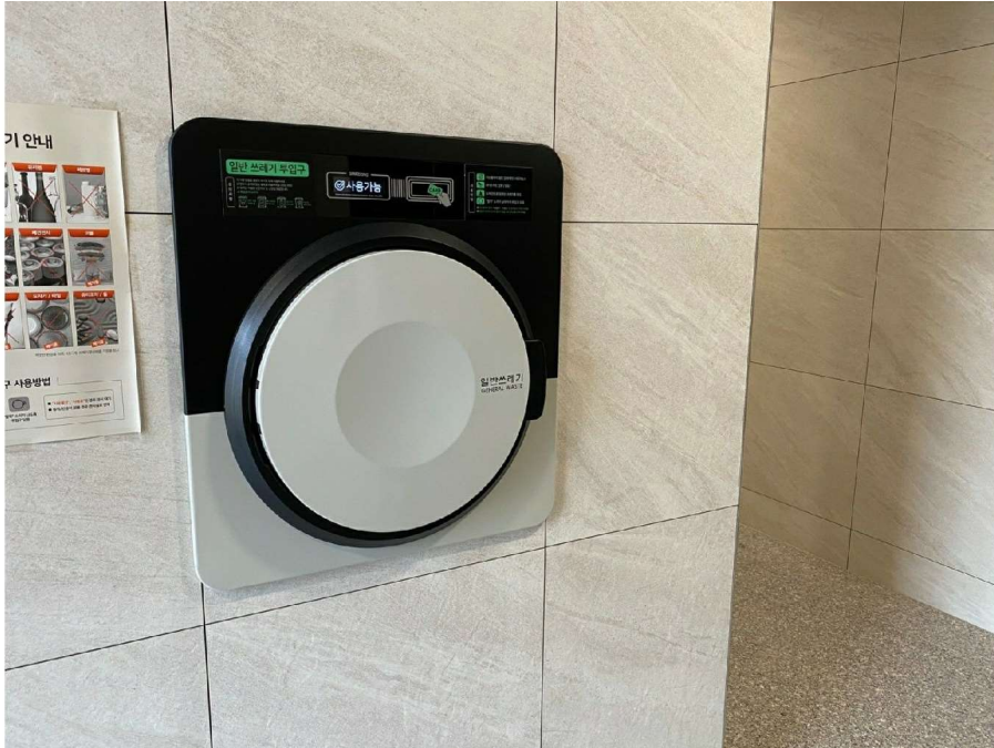
공용복도에 설치된 설비
